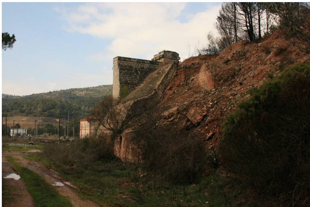
Fotografia 8: Aspecte del terraplenament del fals túnel del tren, amb erosions i inestabilitats.
