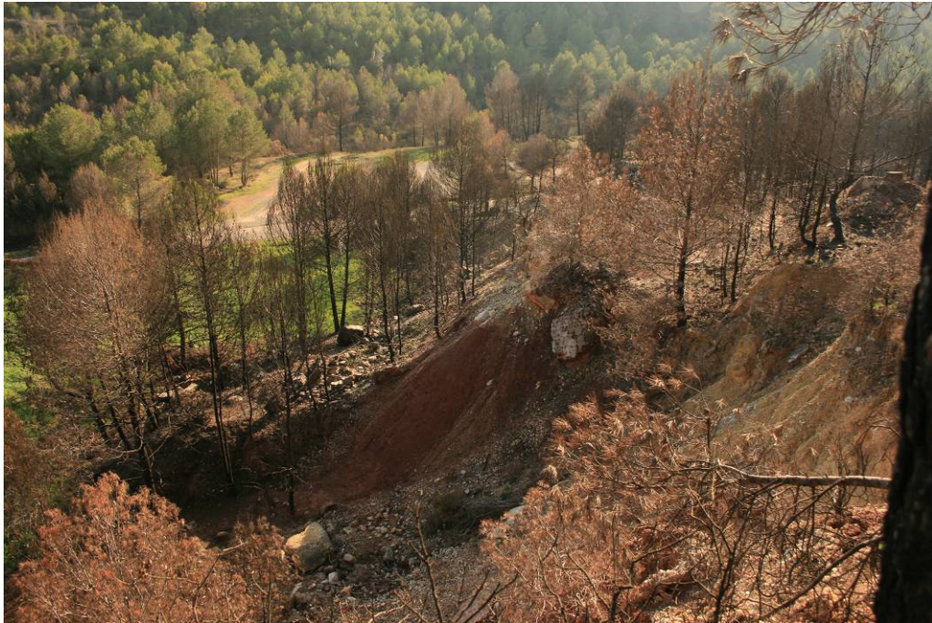
Fotografia 7: Lliscament en un talús d'una antiga extracció, on afloren les argiles de la unitat Tm2. Els blocs calcaris de la unitat Tm3 han lliscat per damunt les argiles i s'acumulen al peu de la carretera.
